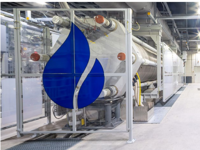
Ausschnitt: H 2 -Pilotanlage Elektrolyse | Foto: RWE
